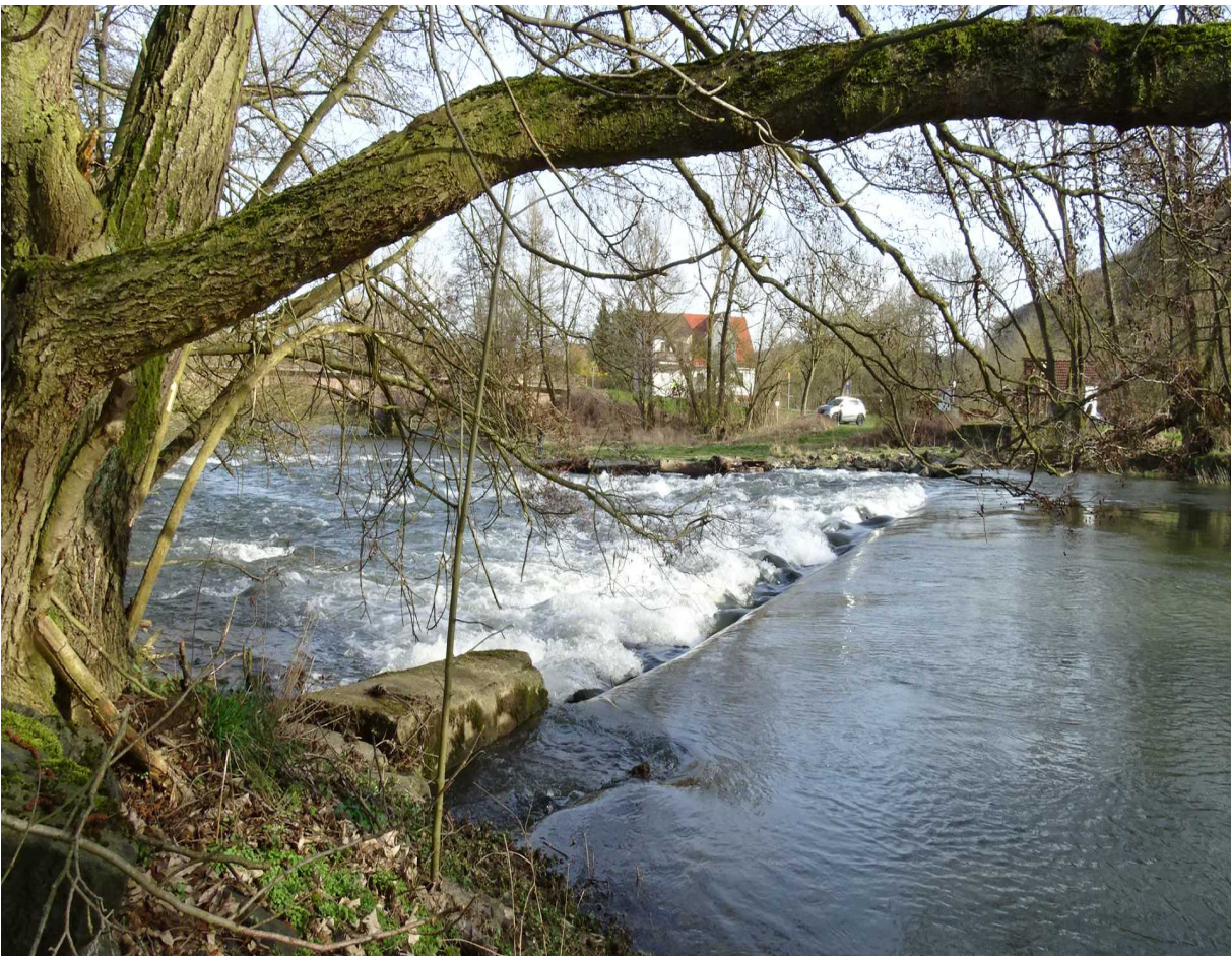
Wehranlage Kernbach, Totale und Wehrkrone, Normalwasser März 2020
